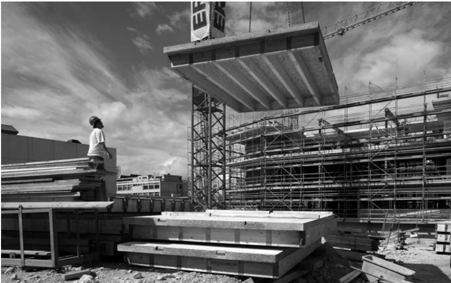
Figure 4 : Montage sur le chantier des éléments de dalles préfabriqués en bois-béton. (photo : Yves André)
